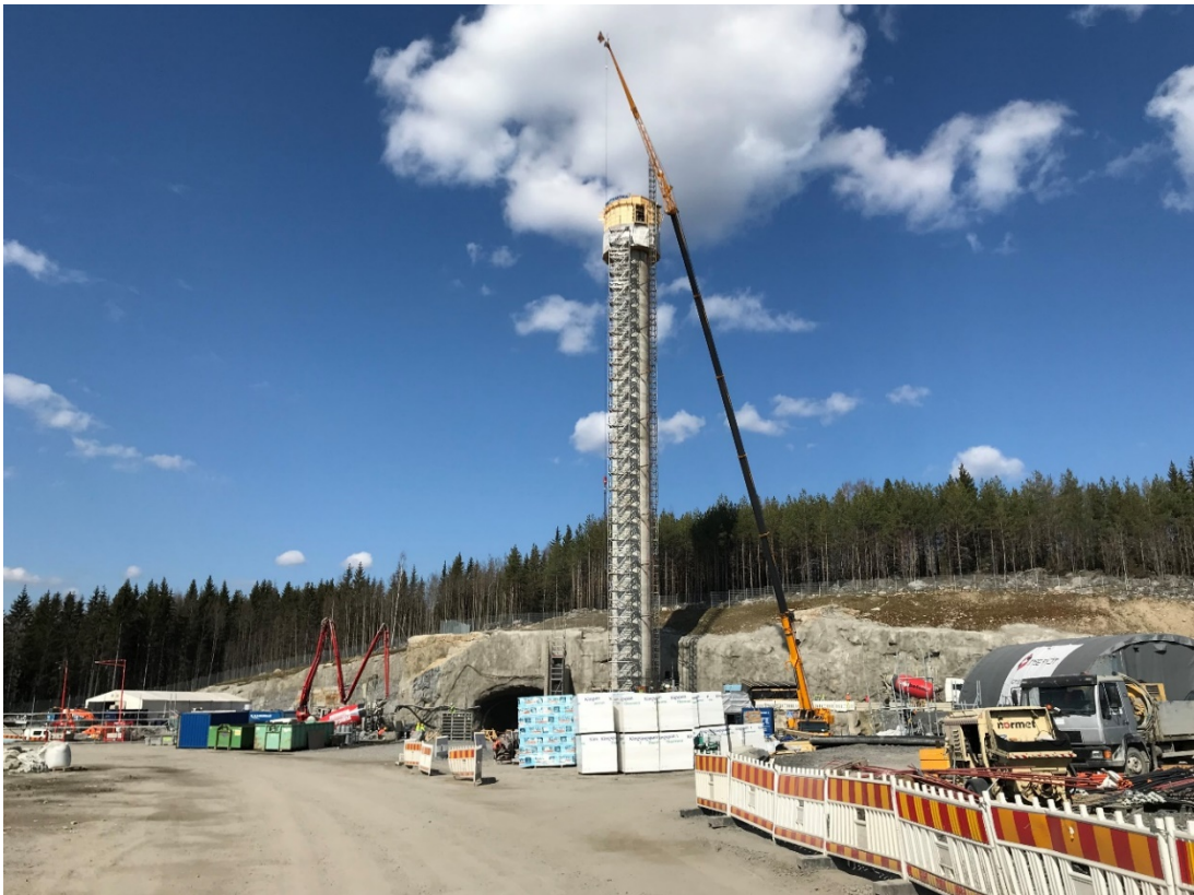
Kuva 6. Sulkavuoren työmaa-aluetta maanpinnalta, jossa keskellä näkyy huhtikuussa rakennettu poistoilma-piippu. (Kuva: Ari-Matti Ilkka).
