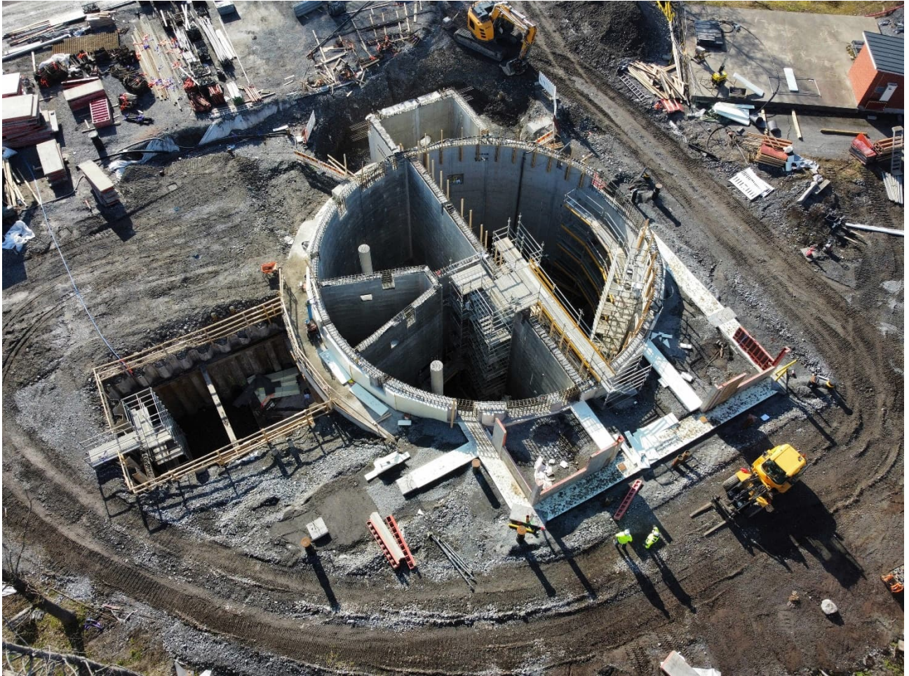
Kuva 12. Viinikanlahden pumppaamon maanalaisia betonirakenteita toukokuussa 2023 (Kuva: Jouni Salmi- nen, NYAB Finland Oy).
