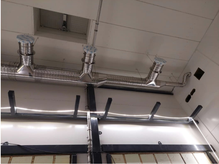
Kuva 4. LVI-urakkaan kuuluvia asennuksia ja laitteita (IV- ja viemäriputket ja savunpoistoluukku) biokaasulaitoksen ajokäytävässä.
