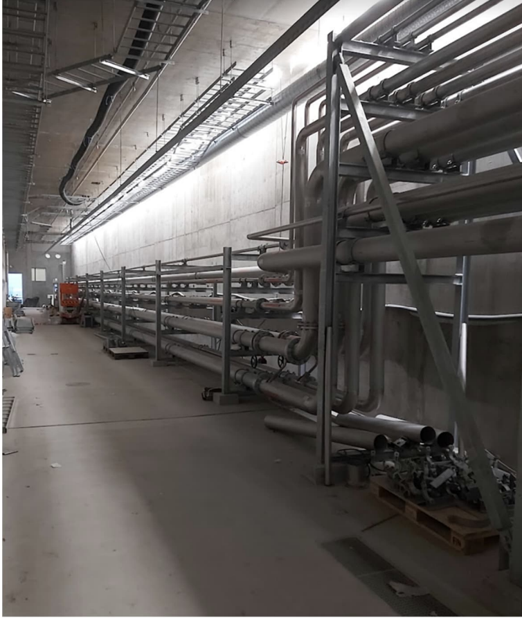
Kuva 2. Tekniikatunnelin prosessiputkiasennuksia. (Kuva: Veli-Matti Hatvala)
