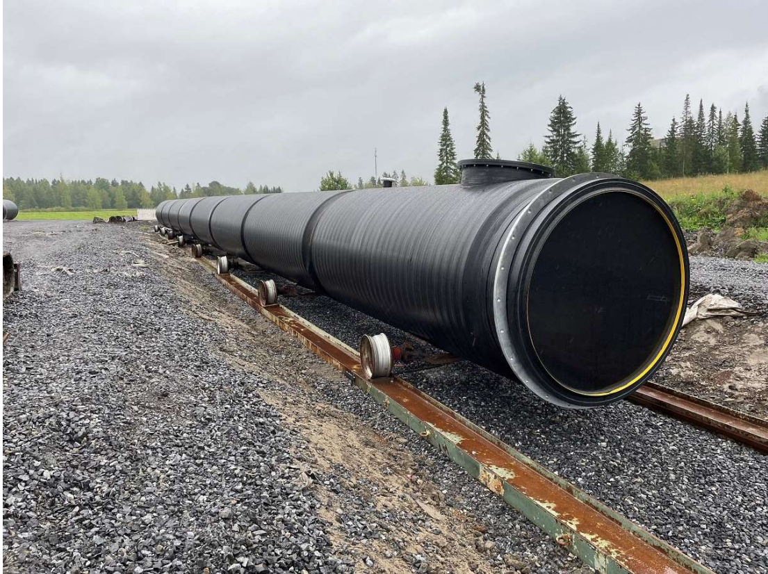
Kuva 13. Kuva hitsausradasta, jonka päälle on asetettu 2 kpl 24 m salkoa yhteen hitsattavaksi (kuva: Ari-Matti Ilkka).
