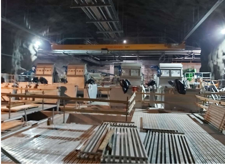
Kuva 3. Välppäys kuvattuna hiekanerotuksen suunnasta. (Kuva: Veli-Matti Hatvala)
