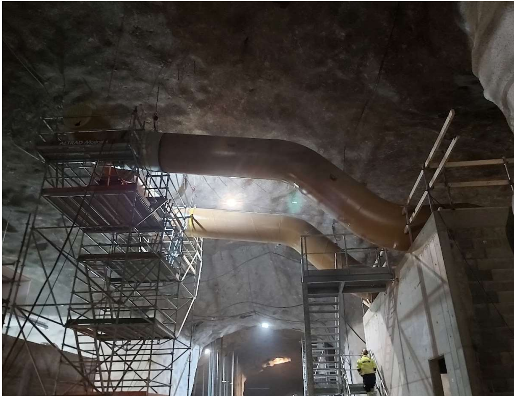
Kuva 3. Ilmastusilman runkolinja käytävällä 4. (Kuva: Veli-Matti Hatvala)
