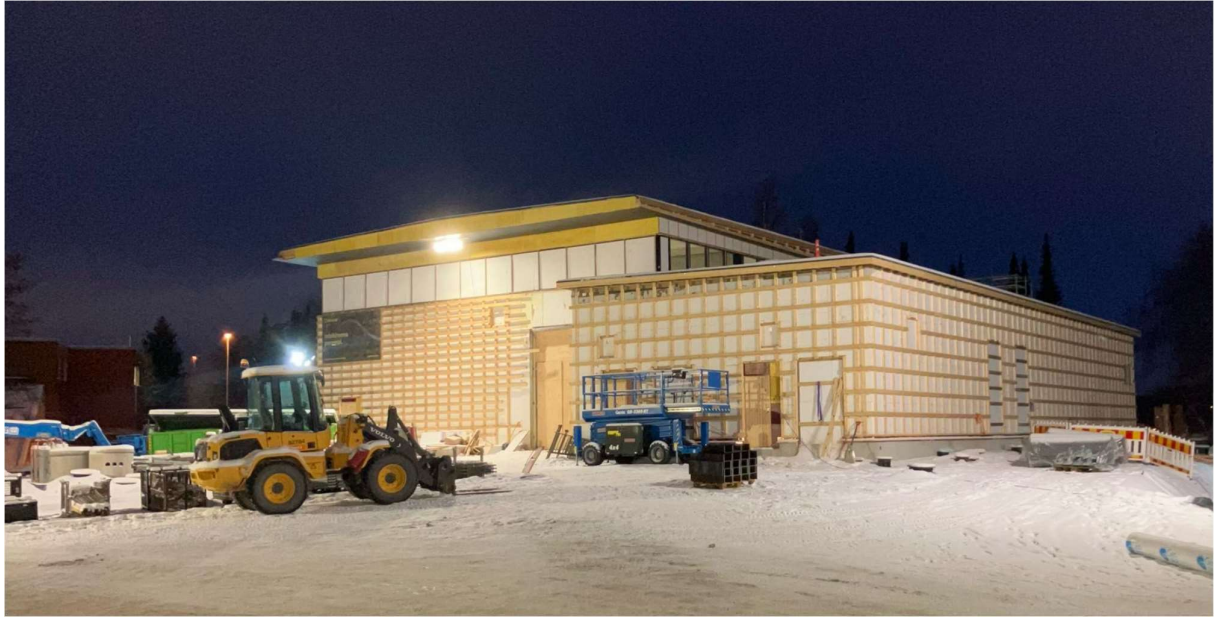
Kuva 15. Viinikanlahden pumppaamon julkisivu ennen julkisivurakenteiden asennusten aloittamista joulukuussa 2023 (Kuva: Pauli Lahtinen, Ramboll CM)
