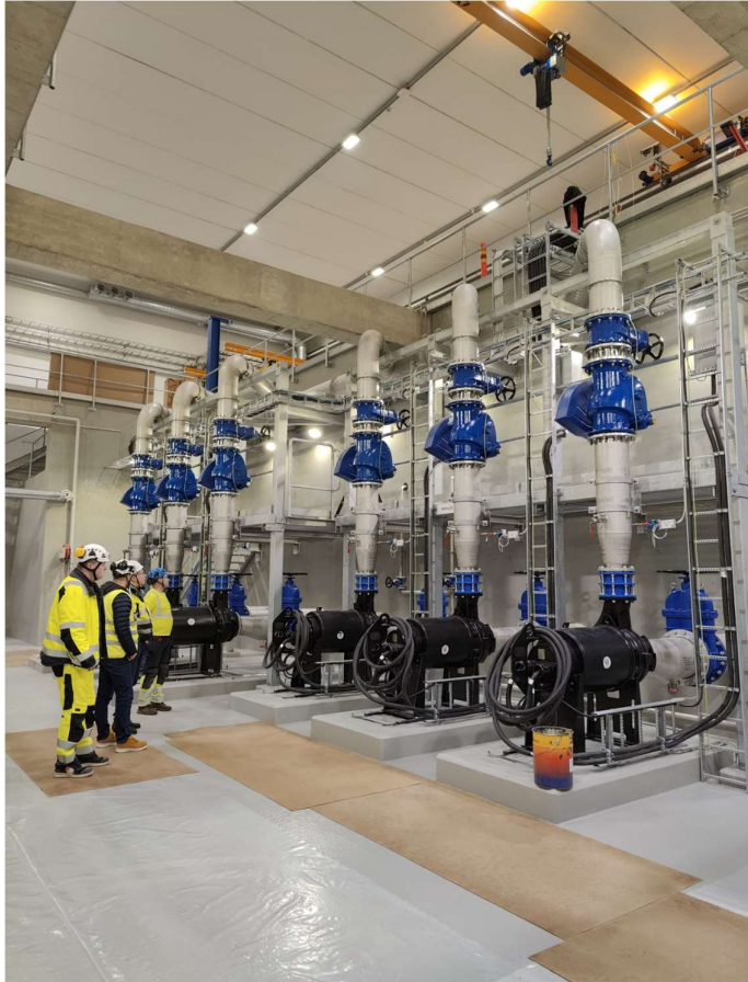
Kuva 17. Sähköasennusten varmennustarkastus Raholan pumppaamon pumppusalissa (Kuva: Marko Mänynsalo, Tampereen Seudun Keskuspuhdistamo Oy).
