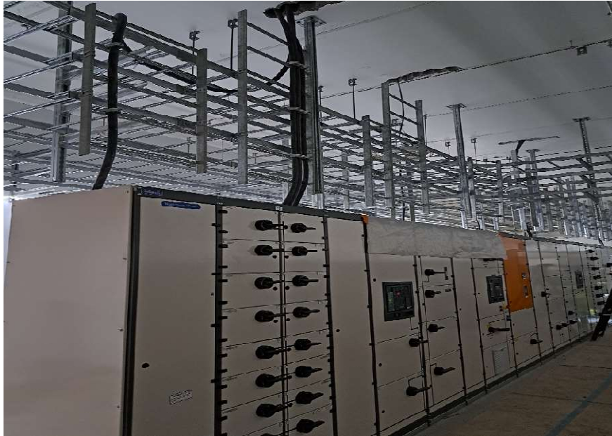
Kuva 7. Sähkökeskuksia luolaston käytävällä 1 valmiina kaapelointia varten (Kuva: Petri Ylönen)
