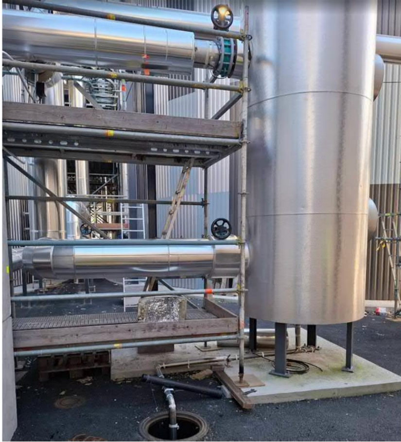
Kuva 1. Loppuvuodesta urakoitsija viimeisteli urakkaan kuuluvia eristystöitä. Kuvassa biokaasuputkistoa. (Kuva: Veli-Matti Hatvala)
