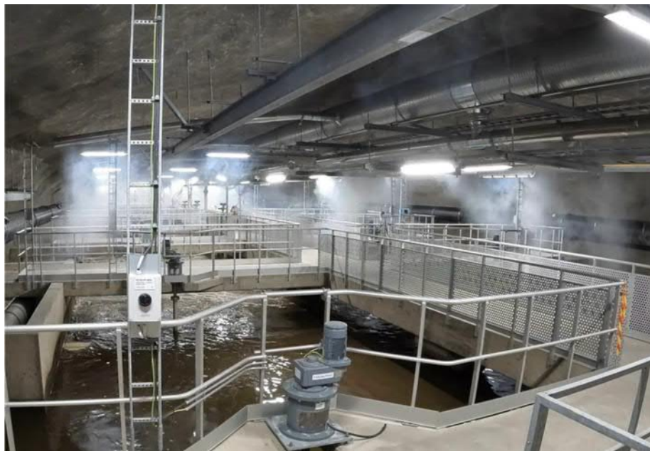
Kuva 2. Ilmastushallissa järjestettiin savukoe, jolla tutkittiin, miten tuloilma jakaantuu työskentelytasolle. (Kuva: Ote Caverionin videosta)
